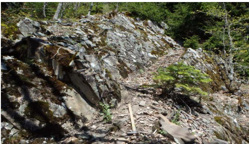
ნახაზი 25: მდგრადი გარღვევები არის წარმოდგენილი მორფოლოგიური შვერილის უბანზე, სადაც სადაწნეო მილსადენი გადის ფერდობის გასწვრივ.
