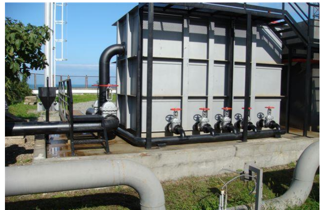
სურათი 5.1.6. 7. კოალესცენტური სეპარატორი და გამყვან მილზე დამონტაჟებული ნავთობის ნახშირწყალბადების კონცენტრაციის პერმანენტულად გამოზომი ხელსაწყო
