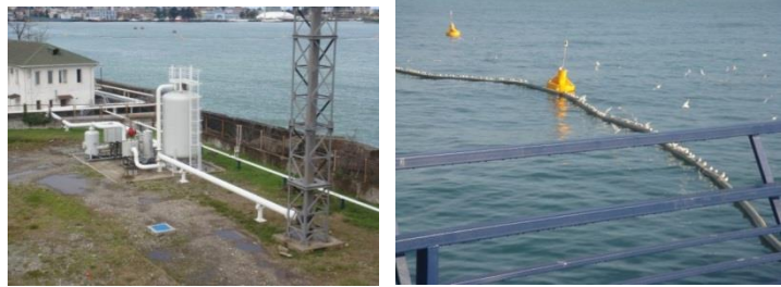
სურათი 3.16.2.2. აირგამწმენდი დანადგარი ნავმისადგომის უბანზე და უნაპირო ნავმისადგომიდან გაფრქვეული აირების გამყვანი მოტივტივე შლანგი
