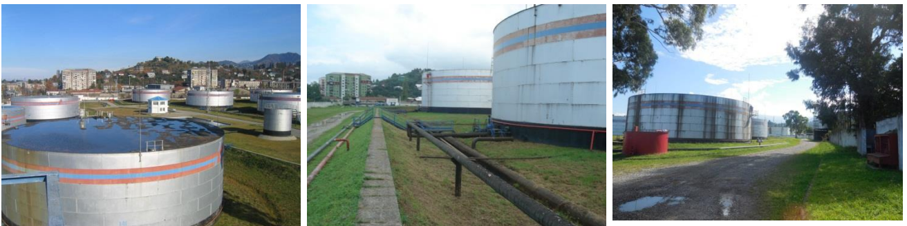
ნახაზი 3.3.4.1. ხალოდნაია სლობოდას რეზერვუარები
