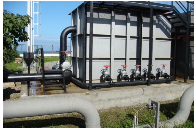
სურათი 5.1.5.7. კოალესცენტური სეპარატორი და გამყვან მილზე დამონტაჟებული ნავთობის ნახშირწყალბადების კონცენტრაციის პერმანენტულად გამზომი ხელსაწყო
