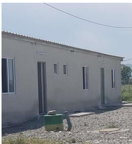
სასაკალოს ტერიტორიაზე მოწყობილი ცხიმდამჭერი
