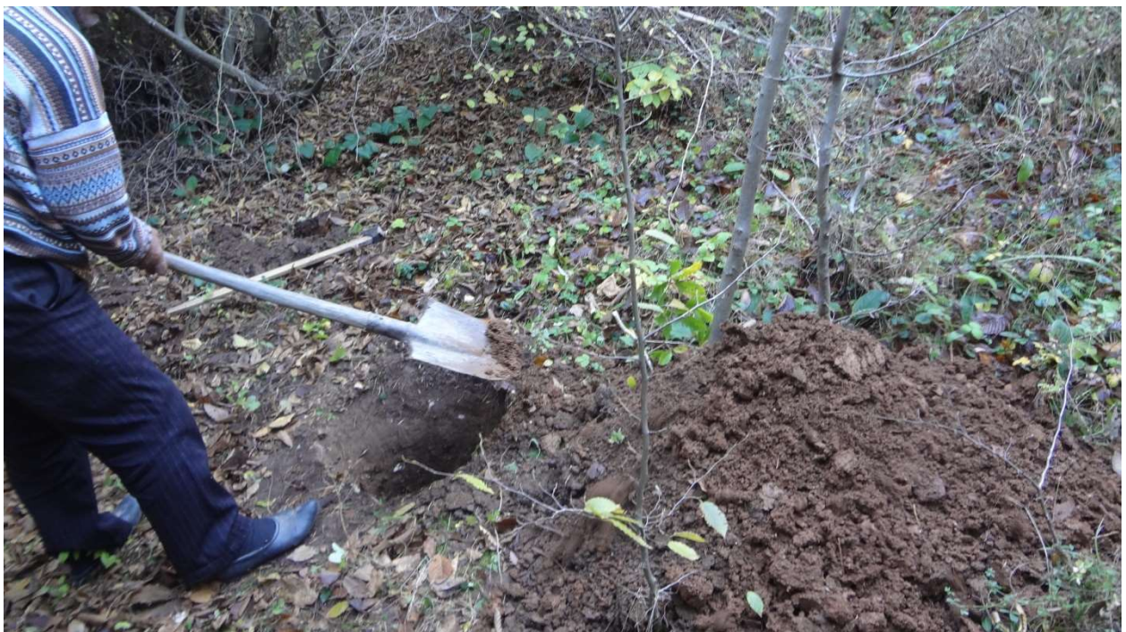
სურათი #6. შურფბურღილის გაყვანის პროცესი #6 საყრდენის განთავსების ადგილზე. რომელიც 0.5 მ სიღრმიდან ლითოლოგიურად წარმოდგენილია მოყვითალო-მოწითალო ფერის ძნელპლასტიკური თიხებით.
