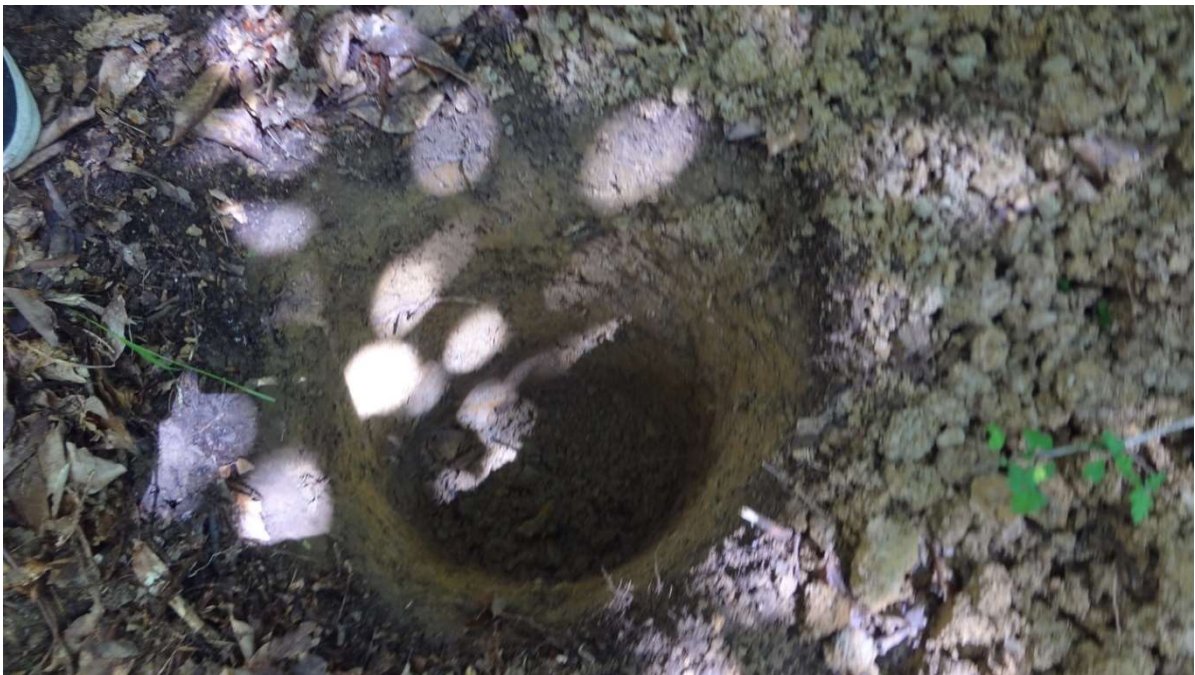
სურათი #28. #28 შურფბურღილის გაყვანის პროცესი. ლითოლოგიურად ის 1.5 მ სიღმიდან წარმოდგენილია ნახევრად კლდოვანი ძირითადი ქანით – არგილითით. საყრდენის განთავსების ადგილი მორფოლოგიურად წარმოდგენილი 15-20^{\circ} დახრილობის ფერდობით, წაბლნარ-წიფლნარი ფართოფოთლოვანი ტყით და თხილის ქვეტყით.
