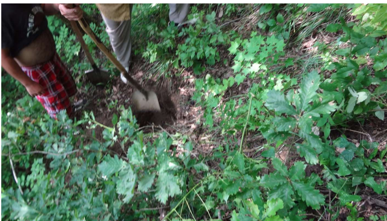
სურათი #20. #20 შურფბურღილის გაყვანის პროცესი 35°-ით დახრილობის, საკმაოდ მწელად ასასვლელ ტყიან ფერდობზე. რომელიც ლითოლოგიურად ზედაპირიდან წარმოდგენილია მყარი კონსისტენციის თიხნარებით.
