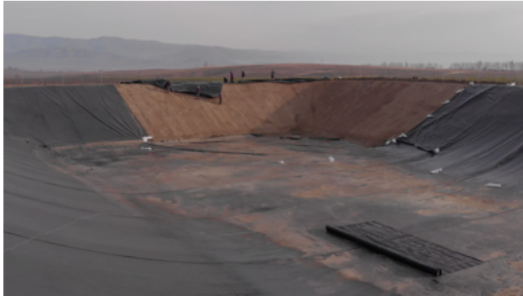
ნახ. 3.9. - წყალშემკრები რეზერვუარი
