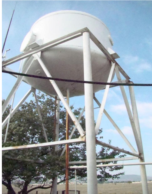
სურ. N 14 - ობიექტის ტერიტორიაზე მოწყობილი ტექნიკური წყლის სამარაგო რეზერვუარი
