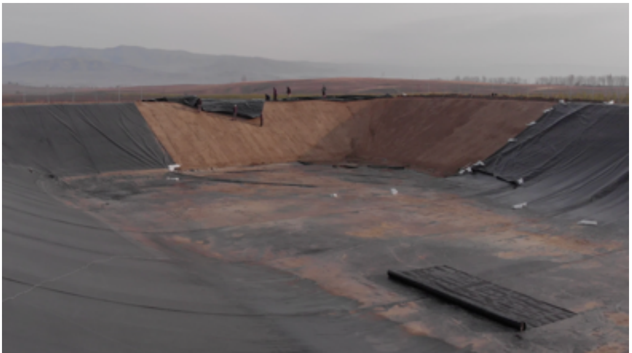
ნახ. 3.9. - წყალშემკრები რეზერვუარი
