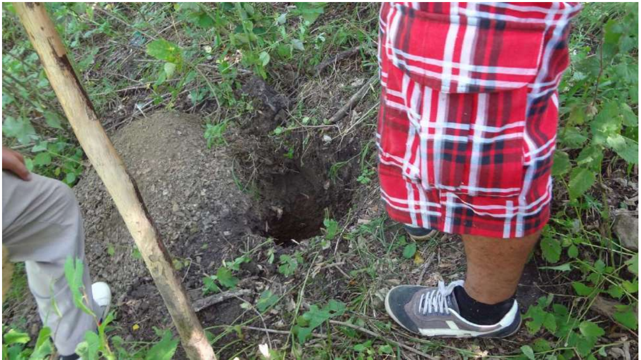
სურათი #17. #17 შურფბურღილის გაყვანის პროცესი, რომელიც ლითოლოგიურად 0.8 მ სიღრმიდან წარმოდგენილია ნახევრად კლდოვანი ქანით – არგილითით. მორფოლოგიურად ადგილმდებარეობა შეესაბამება ფერდობის ზედა ნაწილს, რომელიც დახრილია 30-35°-ით და საკმაოდ მიუდგომელია.
