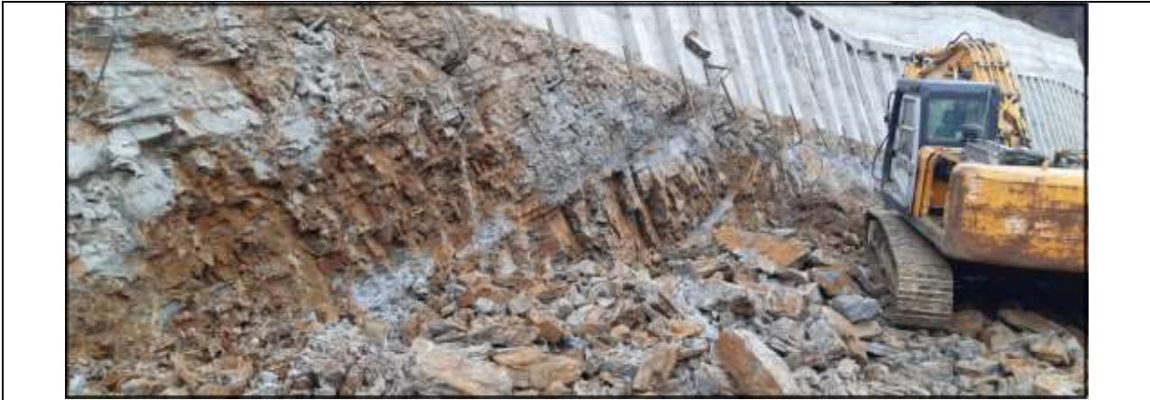
დაკვირვების წერტილი #18. ბეტონის ანკერირებული კედლის ორი რიგი და კარბონატული (მერგელოვანი) ქანების წყება (ასევე გამაგრდება ბეტონის კედლით).
