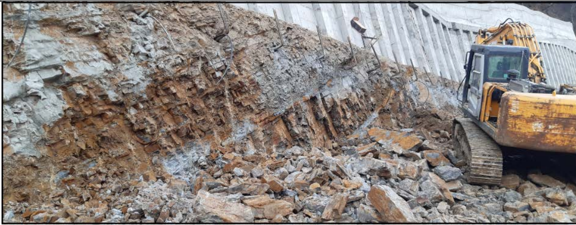
დაკვირვების წერტილი #18. ბეტონის ანკერირებული კედლის ორი რიგი და კარბონატული (მერგელოვანი) ქანების წყება (ასევე გამაგრდება ბეტონის კედლით).
