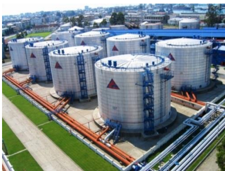
სურათი 3.2.3. №№224 ÷238 რეზერვუარების პარკი ძირითად ტერიტორიაზე
