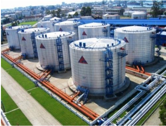
სურათი 5.2.3.3. №№224 ÷238 რეზერვუარების პარკი ძირითად ტერიტორიაზე
