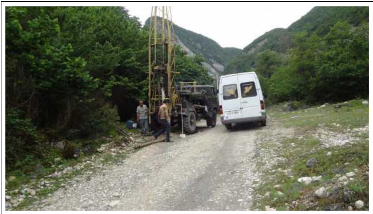
№20 ჭაბურღილის ბურღვის პროცესი. უკანა მარცხენა პლანზე მოჩანს მდ. ჯონოულის ხეობის მარჯვენა ფლატე პალეოგენური ასაკის (Pg) კირქვებისგან შემდგარი ფერდობი
