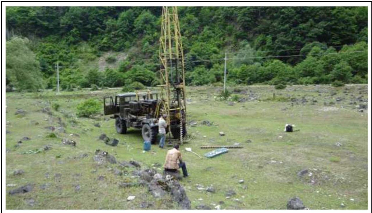
№ 25 ჭაბურღილის ბურღვის პროცესი საპროექტო ჰესის ტერიტორიაზე – მდ. ჯონოულის მაღალი ჭალის ტერასაზე. ხედი სამხრეთ-დასავლეთით უკანა პლანზე მოჩანს ელექტროგადამცემი ხაზი და გაუმჯობესებული გრუნტის გზის მონაკვეთი.
