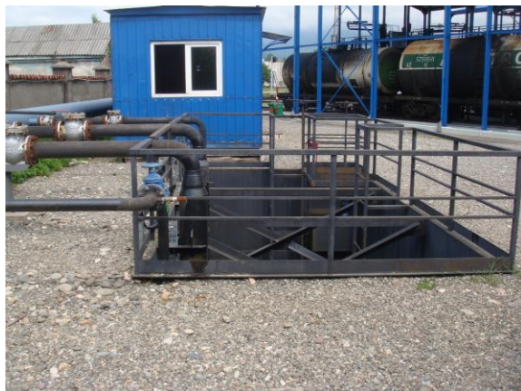
სურათი 5.4.2. #2 სარკინიგზო ესტაკადის სახურავიდან მონადენი წვიმის წყლების მდინარე ბარცხანაში გადასატუმბი სატუმბო სადგურის ხედი.
