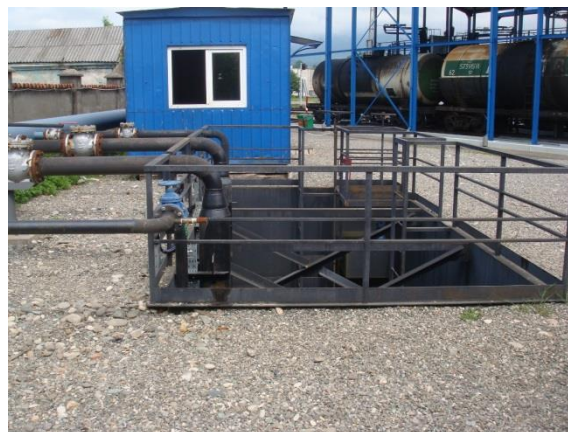
სურათი 7.4.2. #2 სარკინიგზო ესტაკადის სახურავიდან მონადენი წვიმის წყლების მდინარე ბარცხანაში გადასატუმბი სატუმბო სადგურის ხედი.
