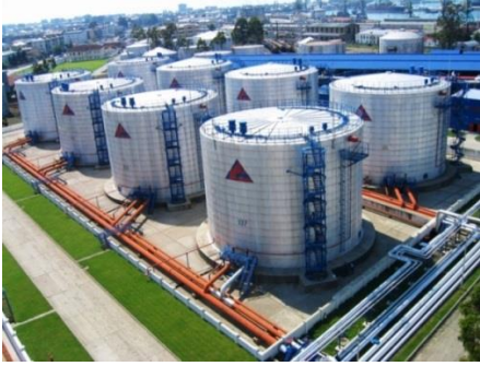
სურათი 3.2.3. №№224 +238 რეზერვუარების პარკი ძირითად ტერიტორიაზე
