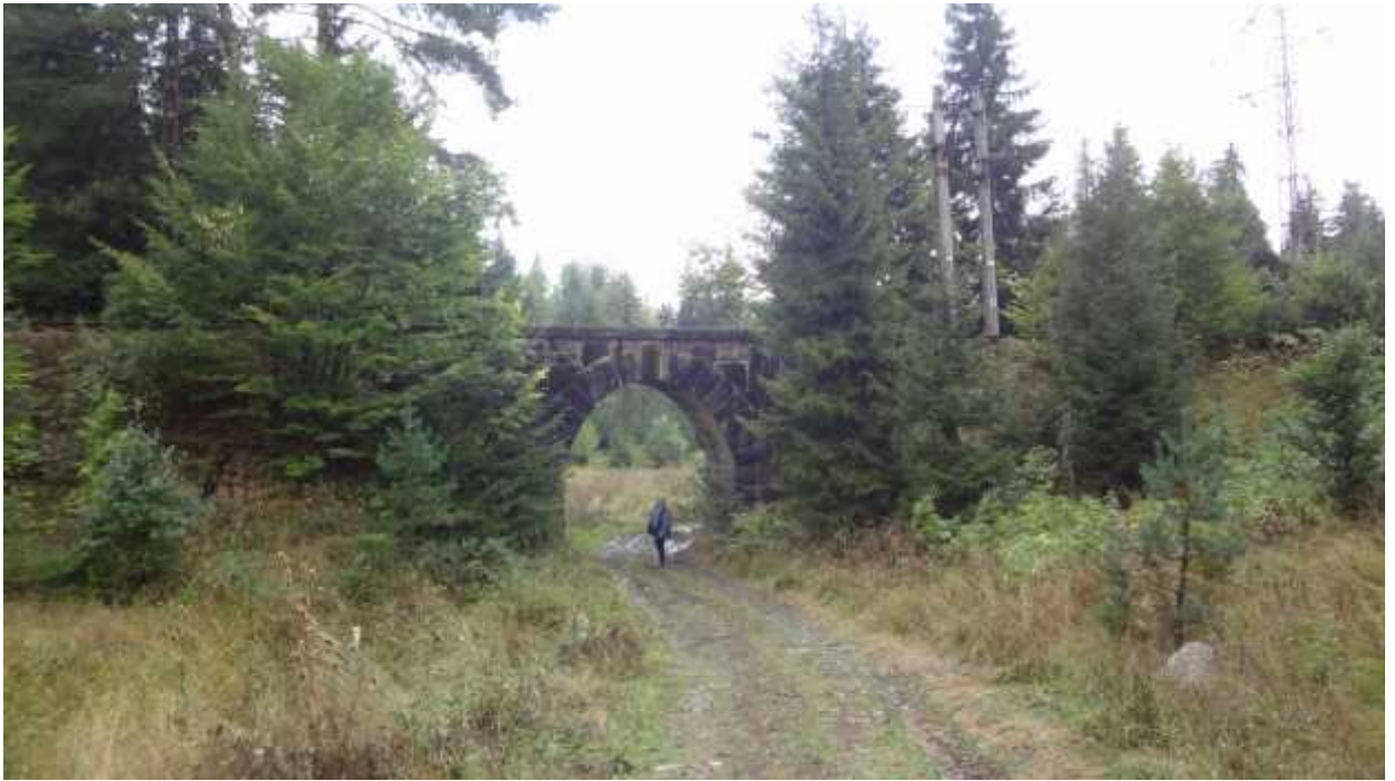
სურათი №18. სურათზე მოჩანს რკინიგზის ქვეშ გამავალი საავტომობილო გრუნტის გზა, რომლის ვაკისზეც გადის მაგთის, სილქნეტის და სოფლების წყალსადენის კომუნიკაციები. საპროექტო სადაწნეო მილსადენი გაივლის არსებული თალიდან მარცხნივ – დასავლეთით რკინიგზის ვაკისის ქვემოთ.
