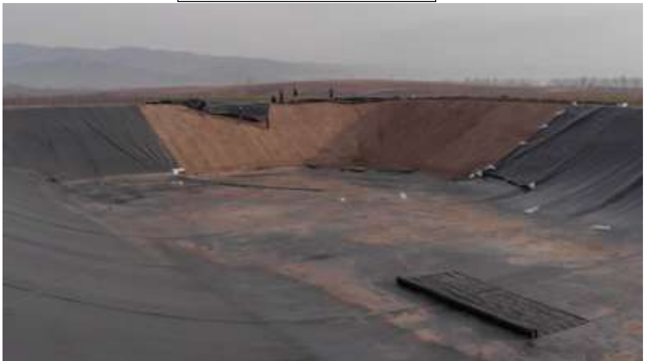
ნახ. 3.15. წყალშემკრები რეზერვუარი
